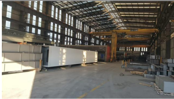
涂装车间（3#、4#车间）内部
