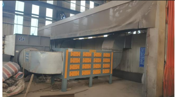
现有有机废气治理设施
