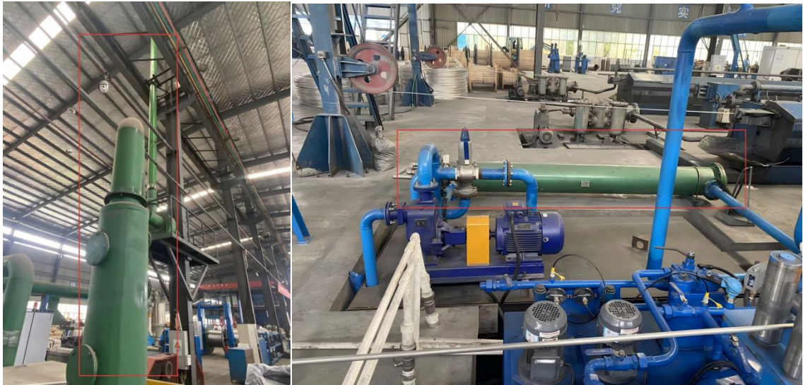
图1 余热回收装置
