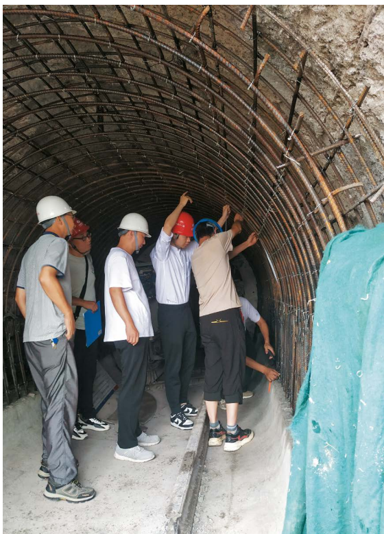
● 2022年7月22日,在小浪底南岸灌区跟踪审计中,审计组测量隧洞内部钢筋绑扎情况 聂一铭提供
