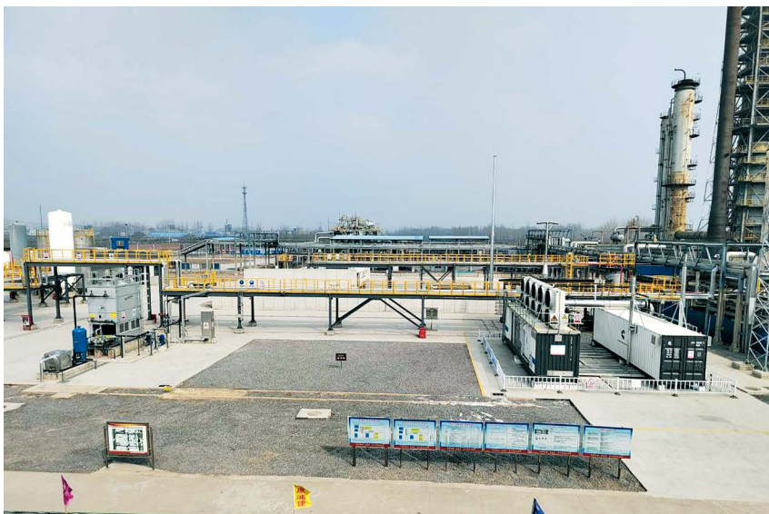
● 2022 年 12 月 25 日, 中原油田兆瓦级可再生电力电解水制氢示范项目建成 杨静提供
