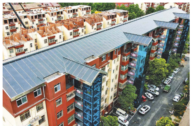
◎ 2022年6月，洛龙区龙瑞B区居民楼楼顶光伏发电板安装完成
