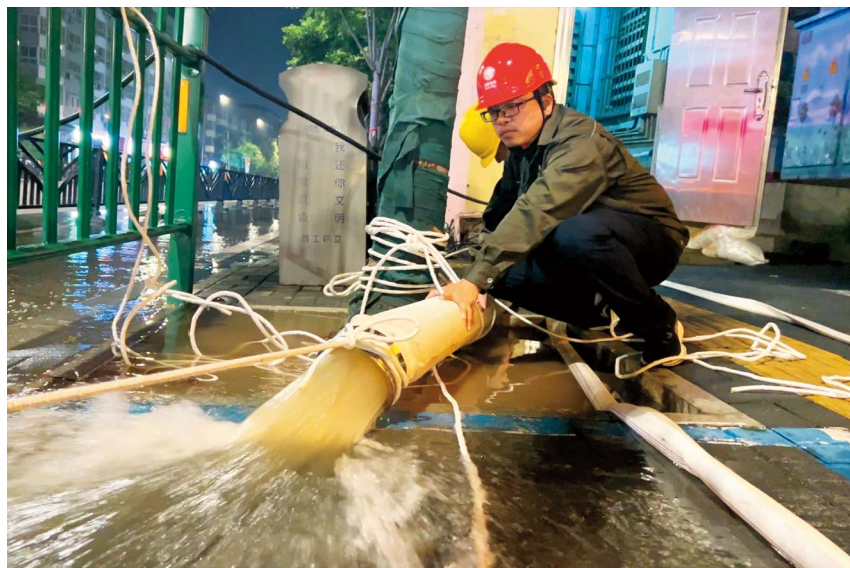
● 2022年7月29日，洛阳供电公司职工利用排水设备对灌水设备区进行紧急排水 王其祥提供
