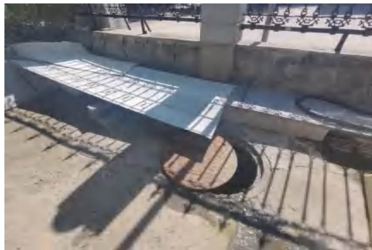
厂区污水总排放口
