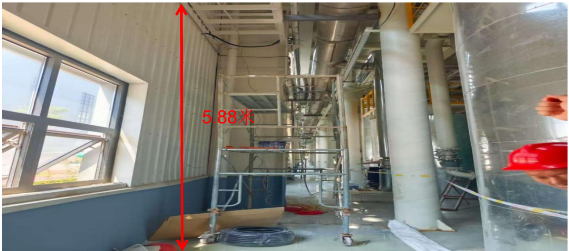
图 5 现场脚手架和上方电缆架
